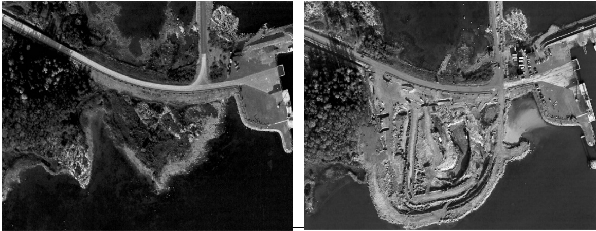
Figur 3-4. Bilder från uppförandet av den befintliga SFR-anläggningen. Bilden till vänster visar Stora Asphällan oktober 1982, bilden till höger visar samma område oktober 1983.
