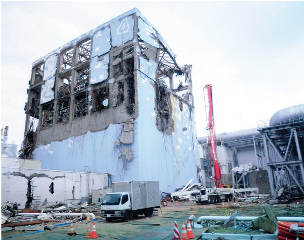
Figur 2 Foto på reaktorbyggnad 4 vid Fukushima I Nuclear Power Plant. Från https://mainichi.jp/english/articles/20160312/p2a/00m/0na/015000c
