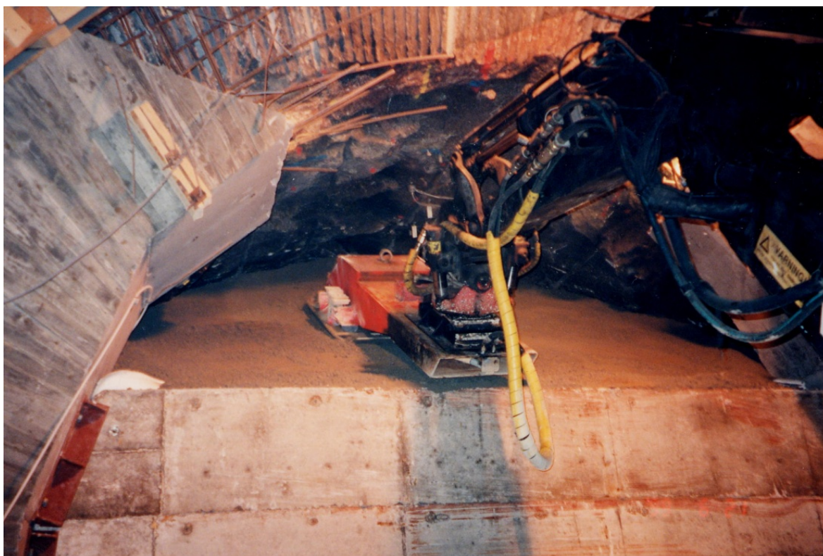
Figur A-6. Packning av material intill mothållande vägg bestående av prefabricerade betongbalkar (Gunnarsson et al. 2001).
